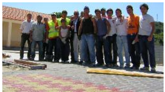
Sistemazione del piazzale della scuola materna a quattro sezioni, plesso Gorgaccio, per 110.768,48 euro.
